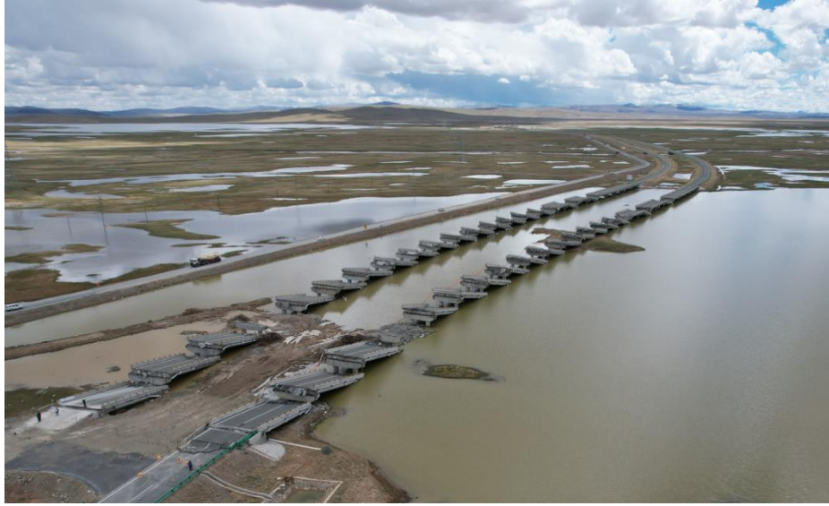
图1 坍塌后的野马滩二号大桥
