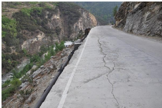
图 36 坡体中前部沉降变形公路
