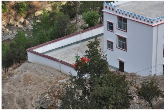
图 34 滑坡前缘房屋拉裂变形
