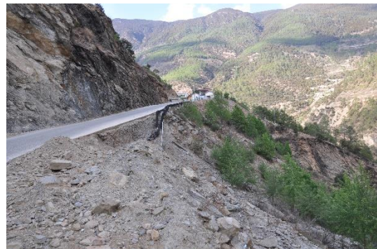
图 37 公路外侧局部变形滑塌体
